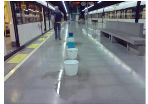
Estació Metro Avinguda
